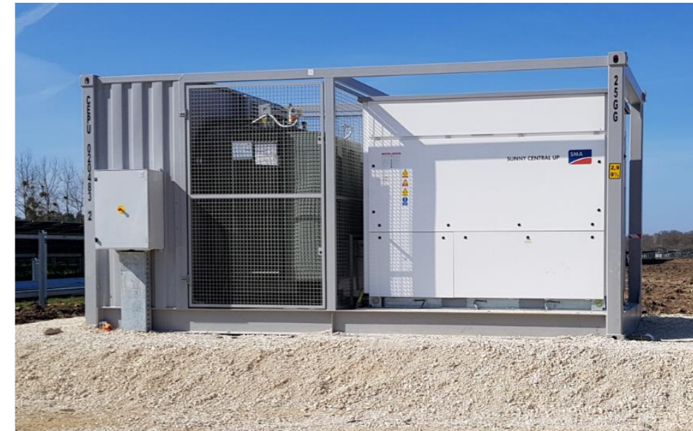
Photo 4 Exemple de poste de transformation (Source : Photosol)
